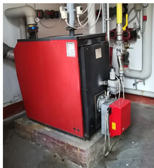
Figura 8.3 - Particolare del generatore di calore attuale
