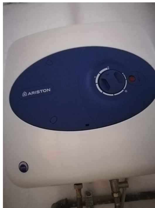
Figura 4.8 - Particolare di un boiler elettrico per la produzione di acqua calda sanitaria
