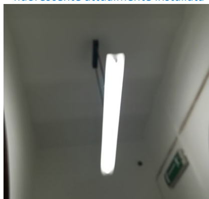
Figura 8.5 - Particolare di una lampada fluorescente attualmente installata
