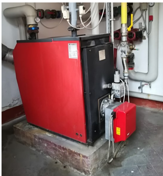
Figura 4.6 - Particolare della caldaia Thermital THE/NG 150
