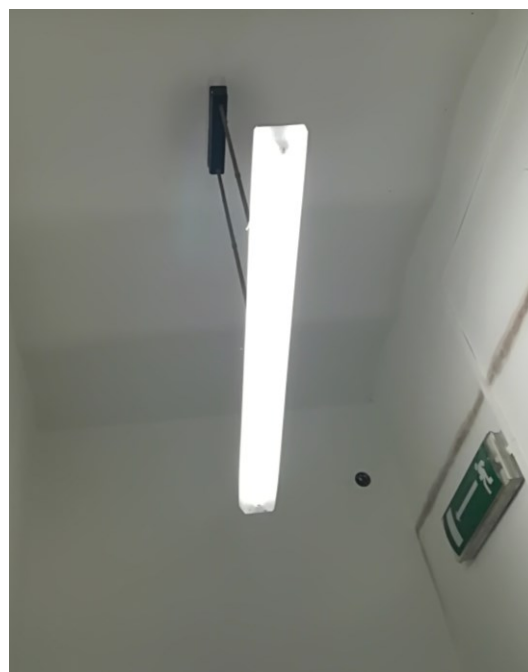
Figura 4.9 - Particolare dei corpi illuminanti ubicati nelle zone di circolazione interna
